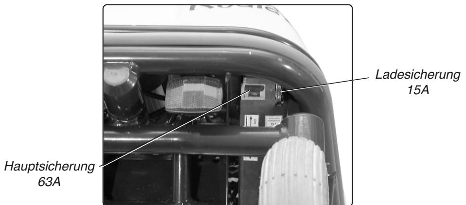
Abb 7. Hauptsicherung und Ladesicherung.
